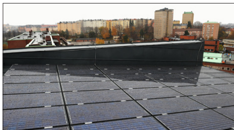
I framtidshuset på Kungsholmen laddar solpanelerna på taket ...
