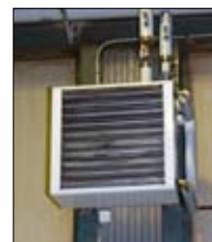
Värmen från fjärrvärmesystemet växlas över till fabriken i tre aerotemperar. Här är ett av aggregaten.
